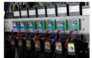
SISTEMA DE PRESIÓN NEGATIVA
